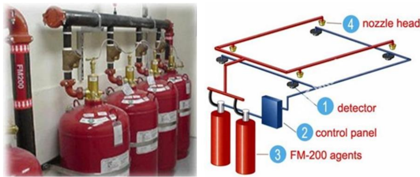
Şekil 5. Yangın söndürme sistemleri [2, 12]
